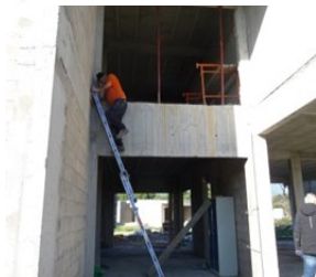
Le risque de chute de hauteur au quotidien !
