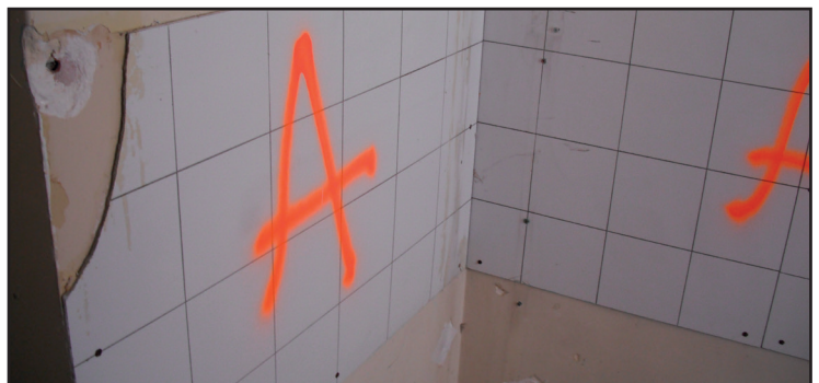
Repérage de colle amiantée sous faïence
