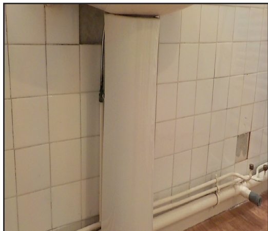
Colle amiantée sous faïence
