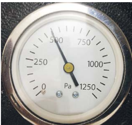
Cadran-manomètre indiquant la perte de charge liée à l'encrassement du filtre de l'extracteur pour une vitesse de rotation donnée du moto-ventilateur.
