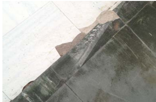
Dalles de sol en vinyle amiante
