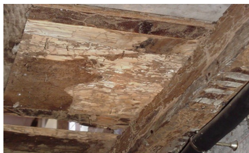
Destruction d'un plancher par les termites
