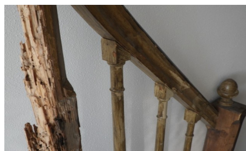
Rampe d'escalier attaquée par les termites
