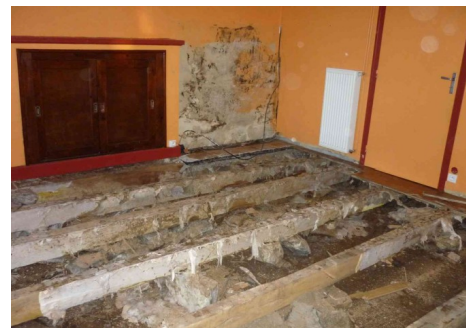
Plancher entièrement infesté par la mэрule
