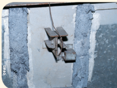
Sonde enrobée d'un mastic souple amianté
