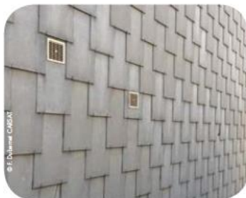
Bardage décoratif en amiant-ciment
