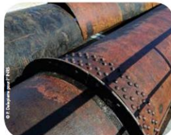
Conduite forcée revêtue de peinture bitumineuse amiantée
