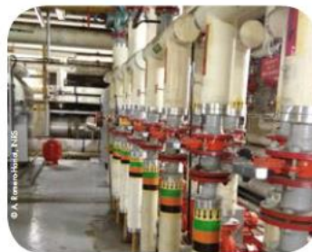
Chaudière d'immeuble collectif
