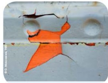
Peinture amiantée sur métal
