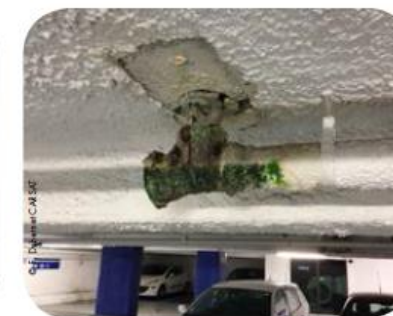
Enduit plâtre chargé à l'amiante
